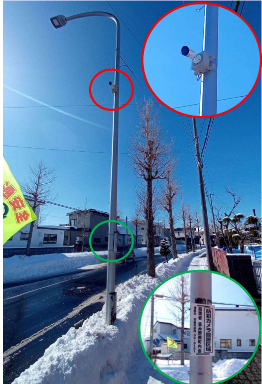
防犯カメラの設置状況
